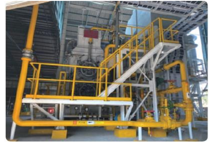
南亞樹林廠天然氣鍋爐
