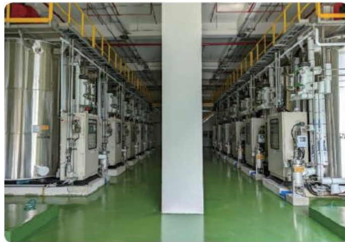
南亞林口廠天然氣鍋爐
