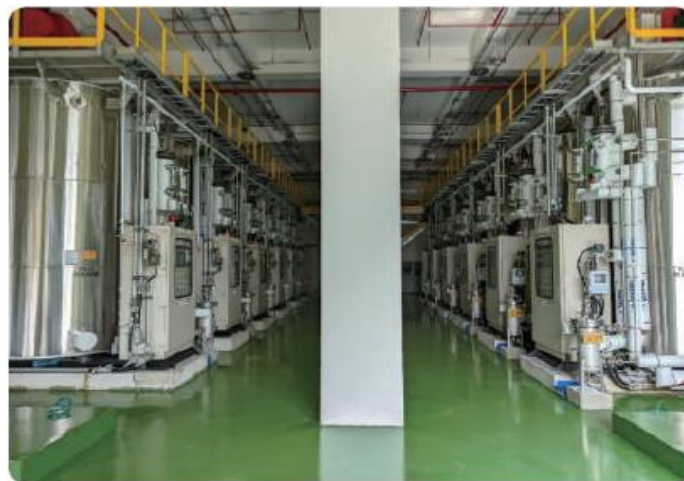
南亞林口廠天然氣鍋爐
