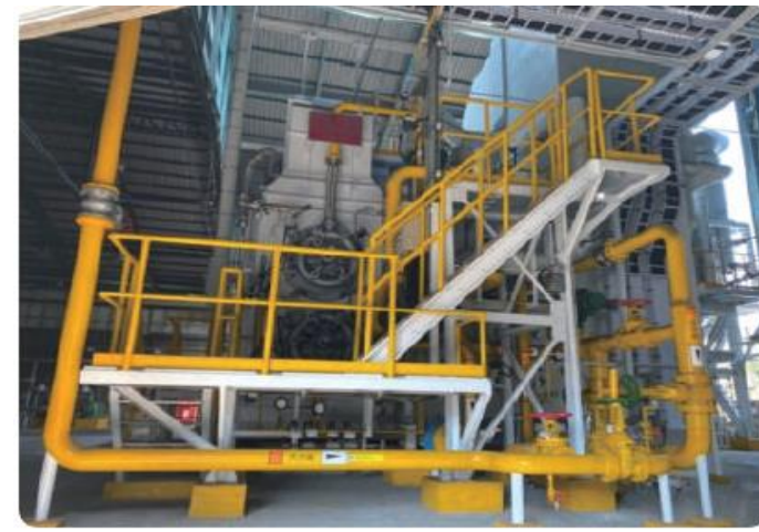
南亞樹林廠天然氣鍋爐
